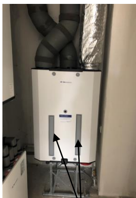
Filtersleuven Ventilatie unit met WTW
