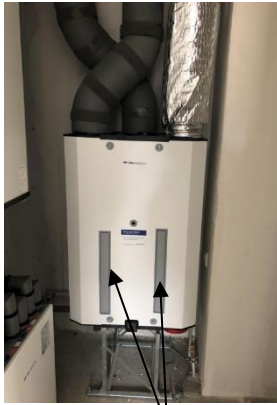
Filtersleuven Ventilatie unit met WTW
