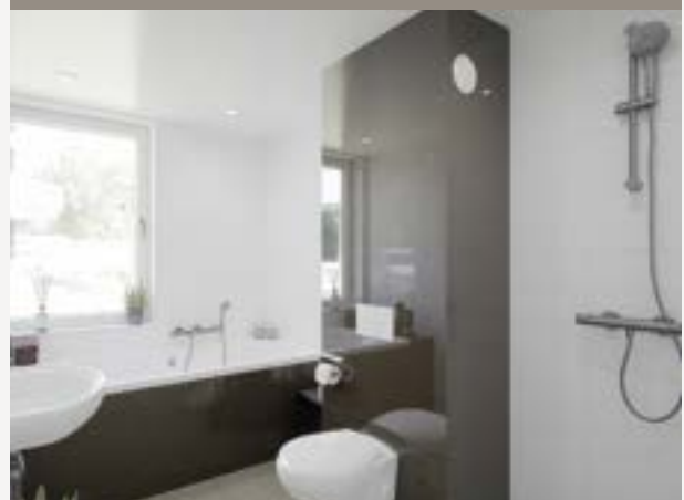
Bad met ombouw in badkamer
